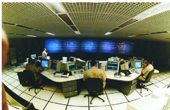
Novo Controle de Tráfego Centralizado (CTC) da EFVM em Tubarão, o primeiro a ser instalado no Brasil com a moderna tecnologia de computação gráfica (acervo ANTF)
